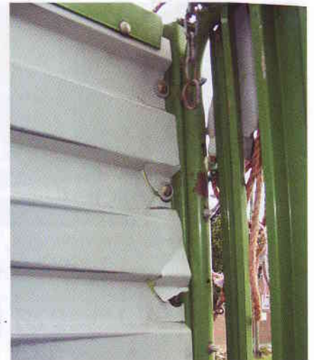
Seltener Fall: Schäden an der Vorderseite einer Seitenwand. Fotos: Theißen
